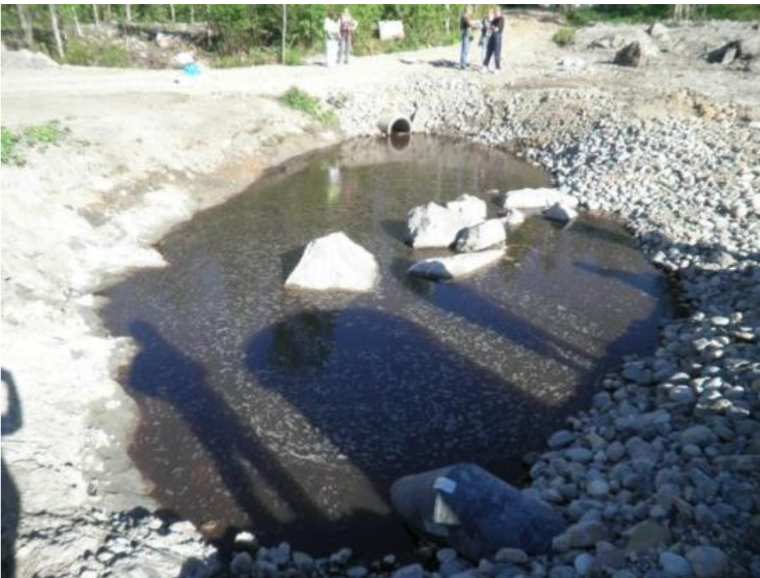
Kemikaalisyöttö saosti tehokkaasti humusta, mikä näkyi runsaana kiintoaineena alapuolisen altaan pinnassa, kuva 28.5.2013.
